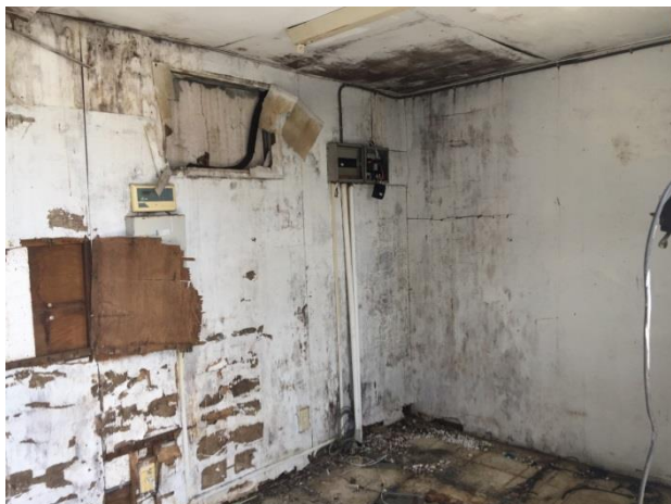
櫃體內部部分情形
